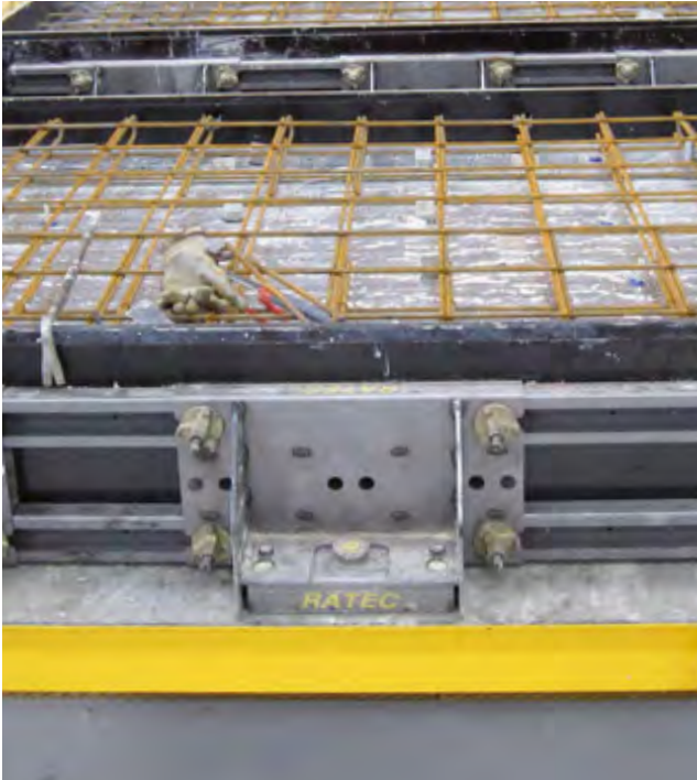
PSV im Einsatz
